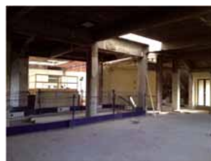
De oude sociëteitszalen en voormalige bibliotheek zijn geheel ontdaan van de uitstraling van weleer.
